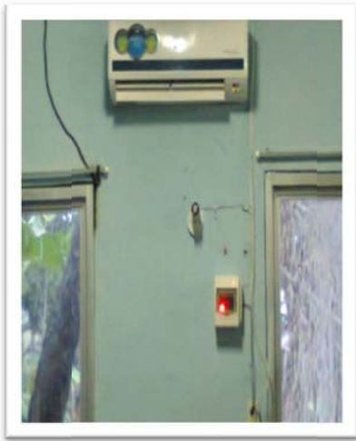
(Sumber : Pengujian Alat ) Gambar 26. AC Dalam Keadaan On
