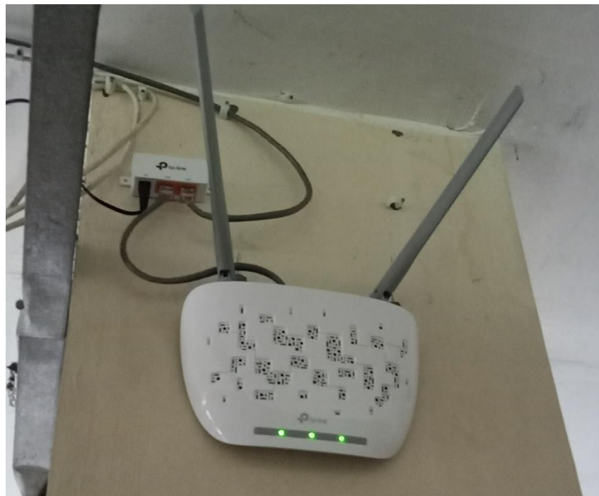
Gambar 9. Access Point di lantai 3
