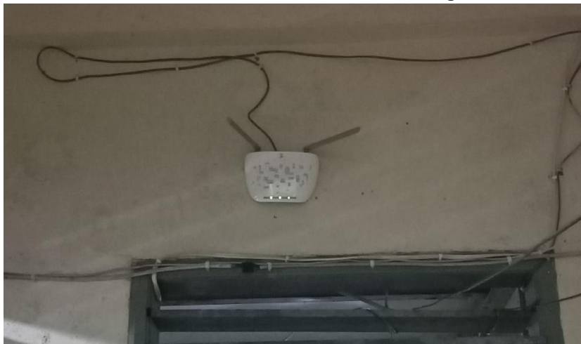
Gambar 7. Access Point lantai 1 di belakang
